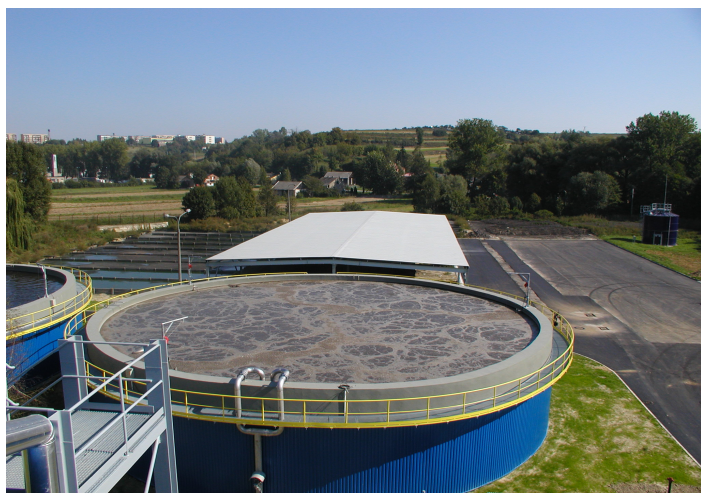
Zmodernizowane komory napowietrzania osadu czynnego
